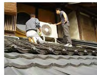
屋根上の室外機（前）
