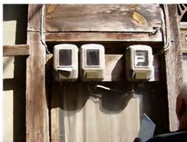
既設メーター器（前）
