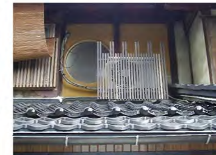
室外機を格子で目隠し（後）
